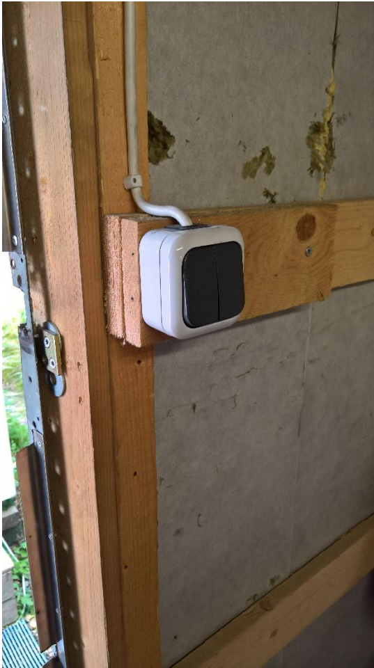
Kuva 1 Vanhan ampumakopin valokatkaisija kytkee sähköt myös vanhaan valvojakoppiin.
