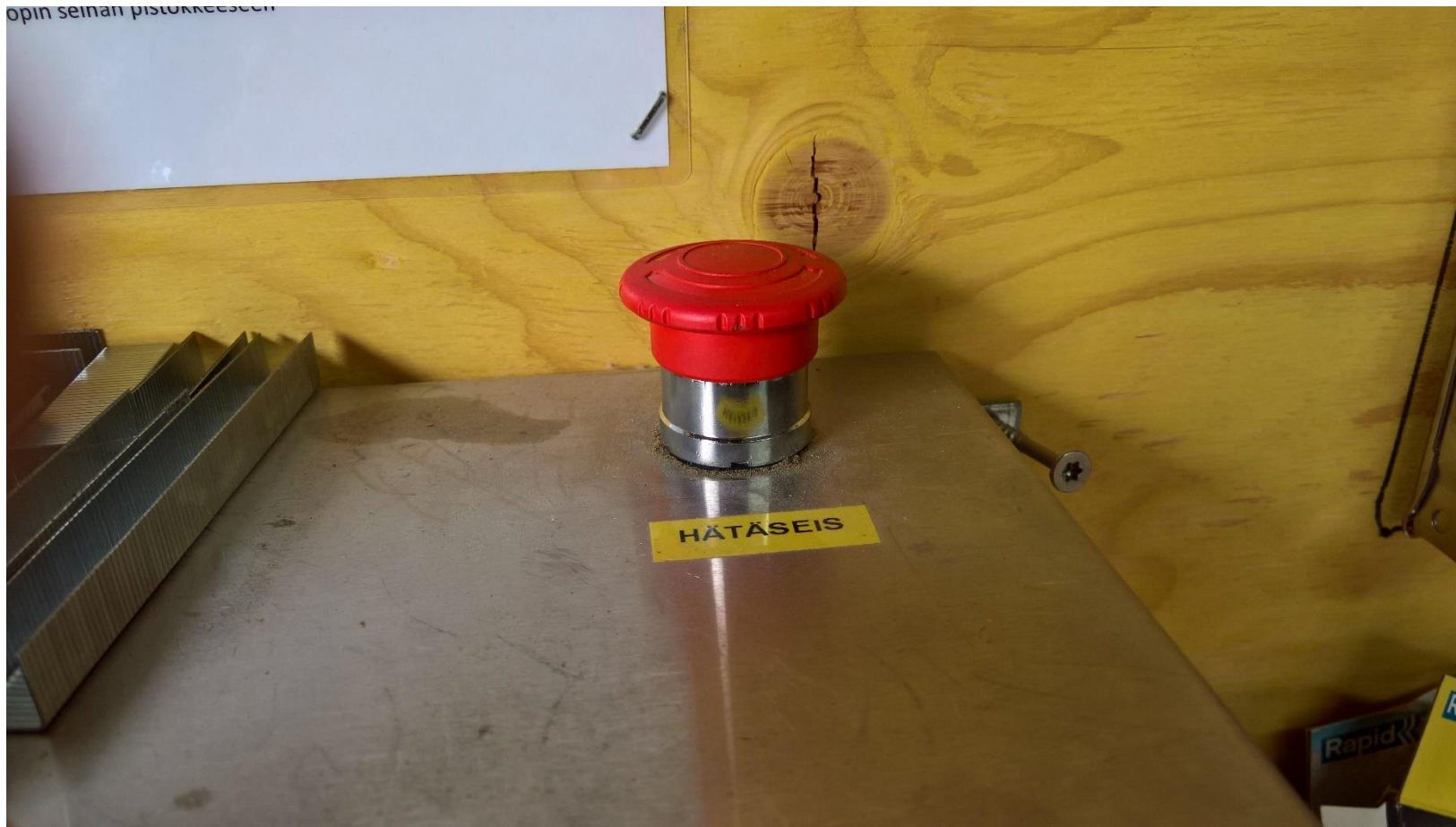
Kuva 3 Hirviradan hätäseis -painikkeeseen ei tule koskea kuin hätätilanteessa. Jos se on painettu hätäseis -asentoon (alas), kytkintä kierretään kevyesti vasemmalle kunnes se nousee yläasentoonsa.
